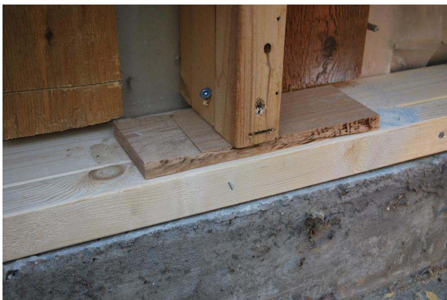
Så här ser den nya syllen ut efter reparationer. Fuktspärren syns inte på bilden
