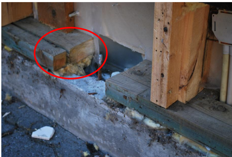
Reparationerna från Ringvägen 17. Att syllen varit våt syns på missfärgningarna efter delning (markerad med en röd ring).
